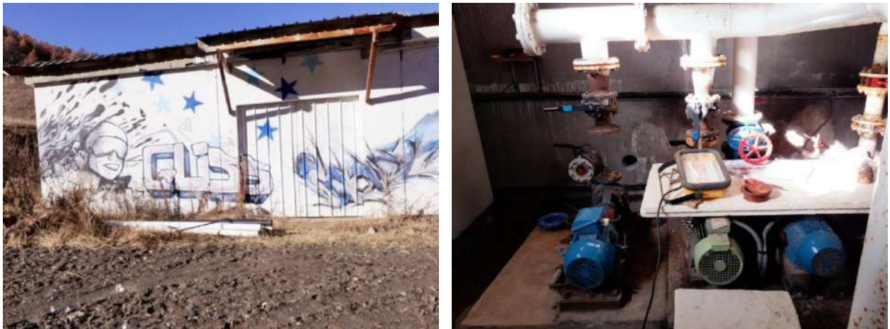
Figure 14 : Photographies de la station de traitement
