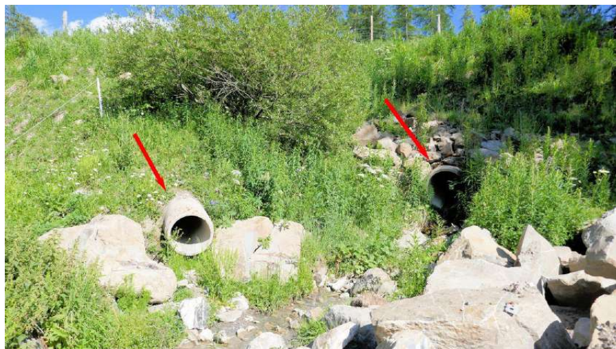
A DROITE, EXUTOIRE PRINCIPAL (Ø800) ET, A GAUCHE, EXUTOIRE SECONDAIRE (Ø500)
